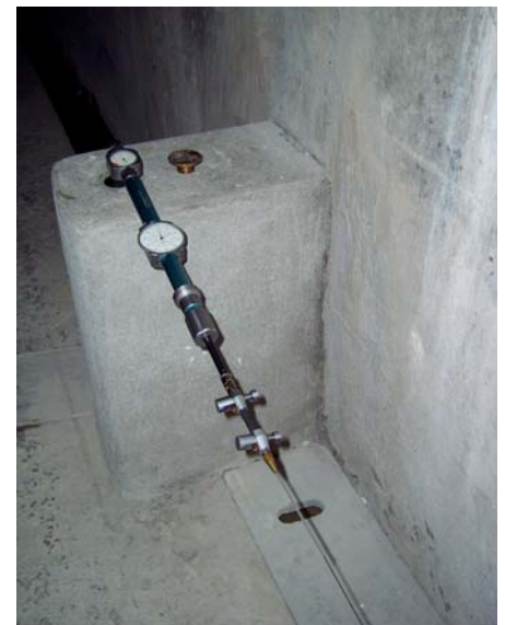
Bild 7. Invardraht-Distanzmessung in einem Kontrollgang der Staumauer Contra.
